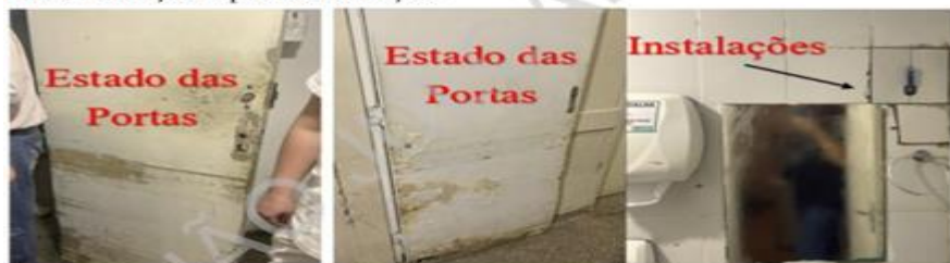
Foto 5 – situação de portas e instalações
