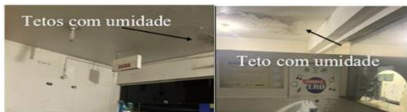
Foto 7 – Condições do teto
