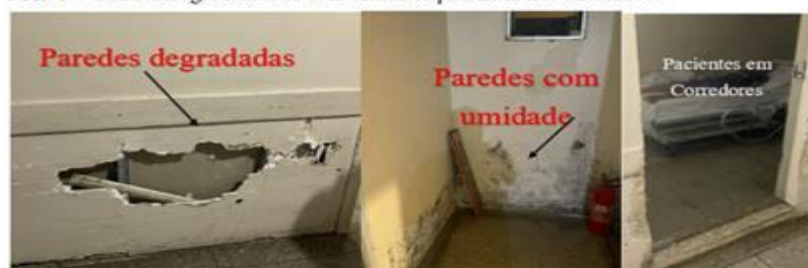
Foto 6 – Paredes degradadas ou com umidade/pacientes nos corredores
